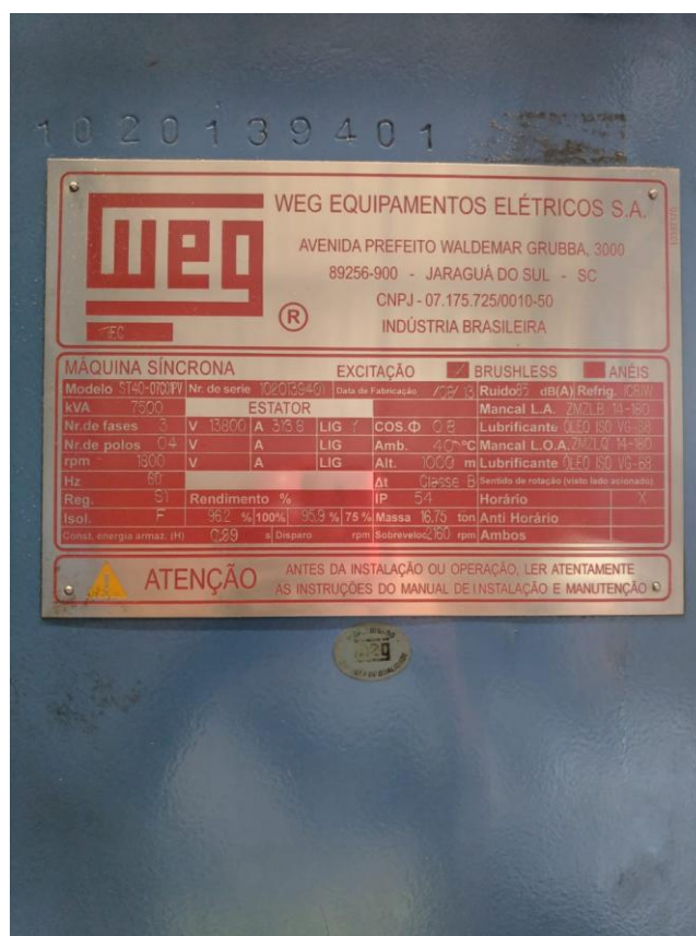
Alternator/ Generator nº 1 – UTE 01
